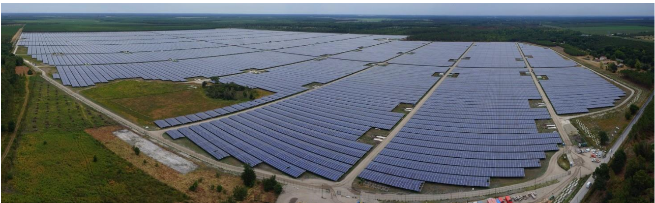
Centrale photovoltaïque de Cestas (Gironde)
